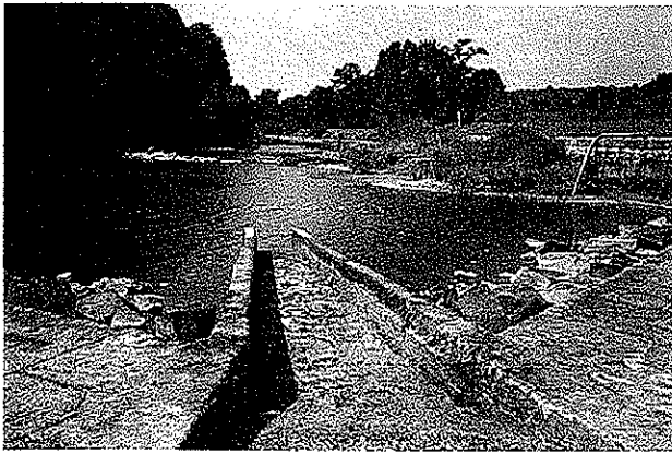
Photo 41 : Vue amont de la rampe à canoës de Kersalic en configuration débarrée. On note l'absence de ralentisseurs au niveau de ce dispositif.
