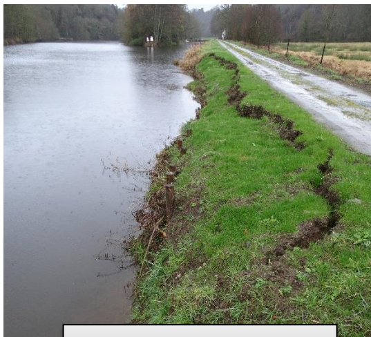
Affaissement de quelques centimètres
