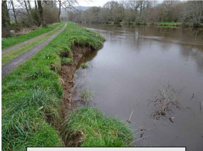
Effondrement récent sans reprise de la végétation
