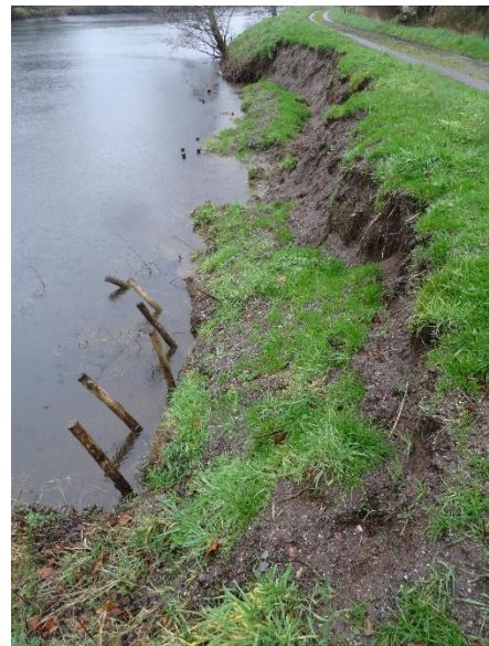
Effondrement en halage survenu sur une zone réparée par le SMATAH
