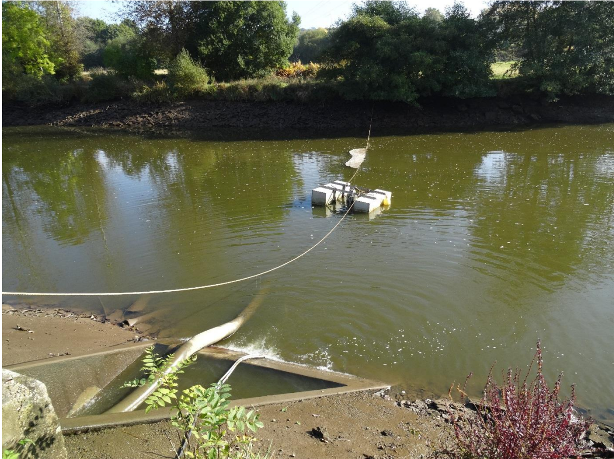
Photo 10 : Pompage provisoire de l'usine de production d'eau potable de Coatigrac'h
