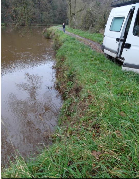
Effondrement ancien avec reprise de la végétation
